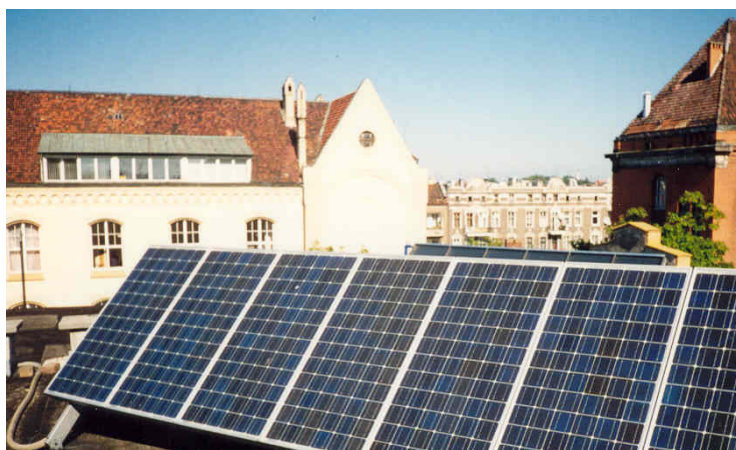
Rys. 14. Zespół paneli fotowoltaicznych Siemens M110 o znamionowej mocy elektrycznej 1,1 kW
