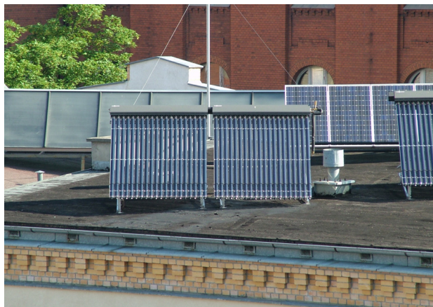
Rys. 12. Zespół kolektorów słonecznych i fotowoltaiczny na dachu budynku KTC
