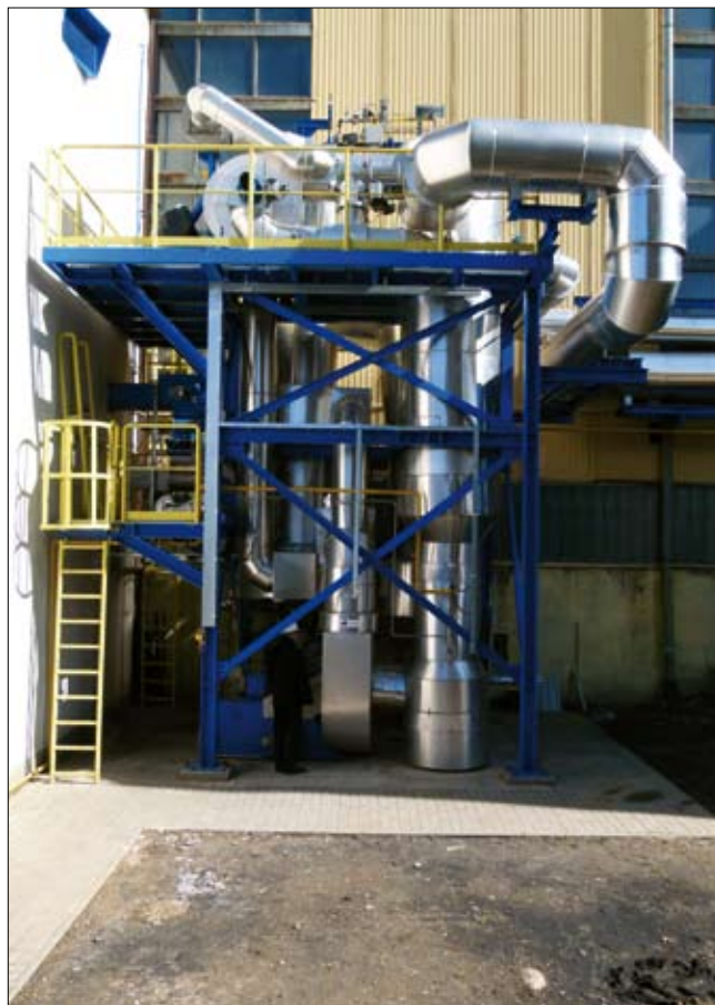
Fot. 4. Blok zgazowarki z wymiennikiem ciepła, cyklonem i wentylatorami
