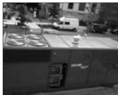
Generator firmy Balard Power System o mocy 250 kW (instalacja użytkowa w Bewag Niemcy)
