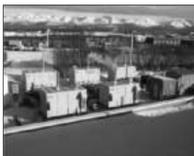
Pięć zestawów wytwórczych z ogniwami paliwowymi firmy Fuel Cells o mocy 200 kW każdy, zasilających urząd pocztowy w Anchorage na Alasce (PAFC).
