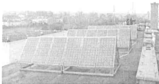
Rys. 5. Widok hybrydowej elektrowni słoneczno-wiatrowej
