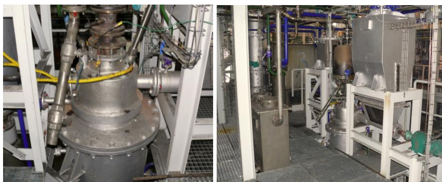
Rys. 2. Widok generatora gazu oraz części pilotowej instalacji zgazowania o mocy 60 kW t [19]
