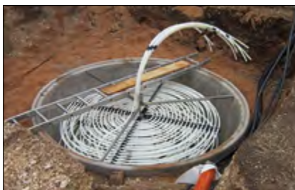
Rys. 5. Zbiornik z wymiennikiem ciepła stanowiący dolne źródło ciepła dla pompy ciepła solanka/woda [4]
