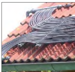
Rys.9. Absorber powietrzno-solarny z rur polietylenowych zamontowany na dachu domu jednorodzinnego
