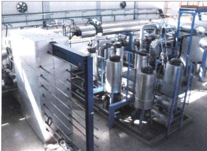
Fot. 2. Wnętrze ciepłowni geotermalnej w Stargardzie Szczecińskim
