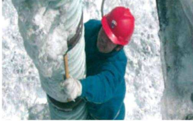
Rys. 14. Usuwanie oblodzenia na izolatorze [15]
