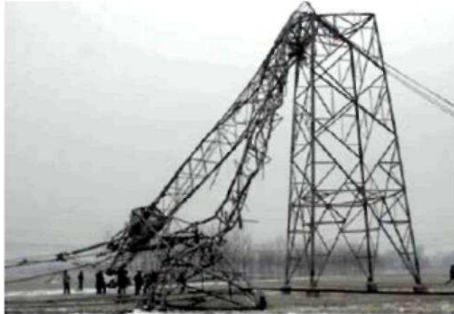
Rys. 12. Uszkodzone słupy przez skrzywienie konstrukcji oraz w wyniku zjawiska „galopady” w przewodzie odgromowym [15]
