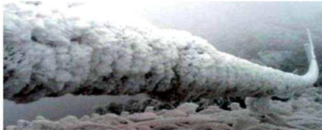
Rys. 11. Oblodzony zerwany przewód napowietrznej linii elektroenergetycznej [15]
