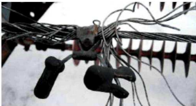
Rys. 13. Zerwanie przewodu przy uchwycie oraz uszkodzone mocowanie izolatora [15]
