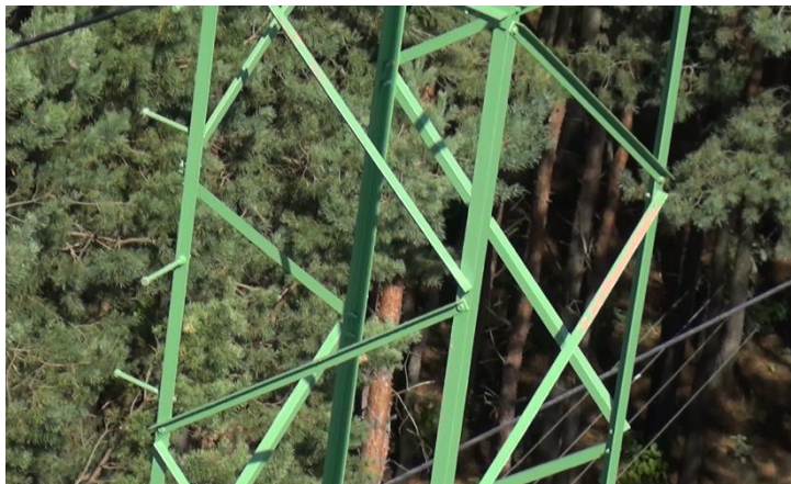
Przykład niedomalowania kątownika na słupie WN podczas oblotu dedykowanego jakości wykonania zabezpieczenia antykorozyjnego
